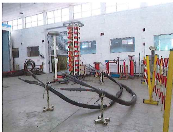
G3: 冲击电压试验 Impulse voltage test
