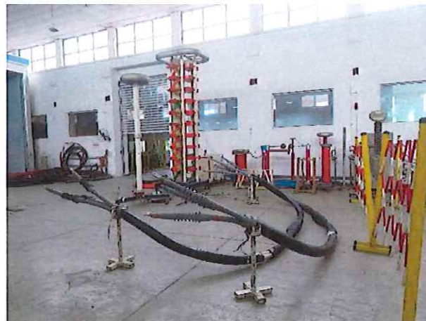
G3: 冲击电压试验 Impulse voltage test
